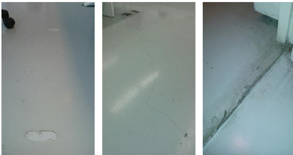
Fotos – Piso em Resinfloor: problemas apresentados
